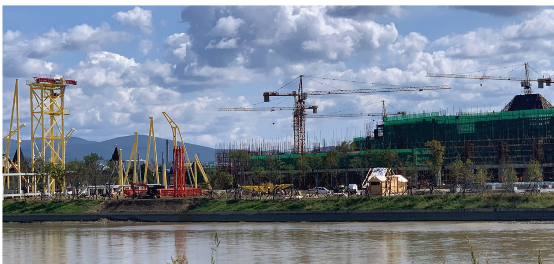
↑珲春市渤海明珠欢乐谷项目进展顺利,预计明年“十一”开放运营。该项目规划总面积约为19万平方米,地上总建筑面积3.5万平方米,预计今年全部完工,各项娱乐设施安装完毕,待检测合格后,室内室外游乐区计划明年“六一”“十一”陆续开放。图为项目施工现场。 本报记者 张凯棋 摄
