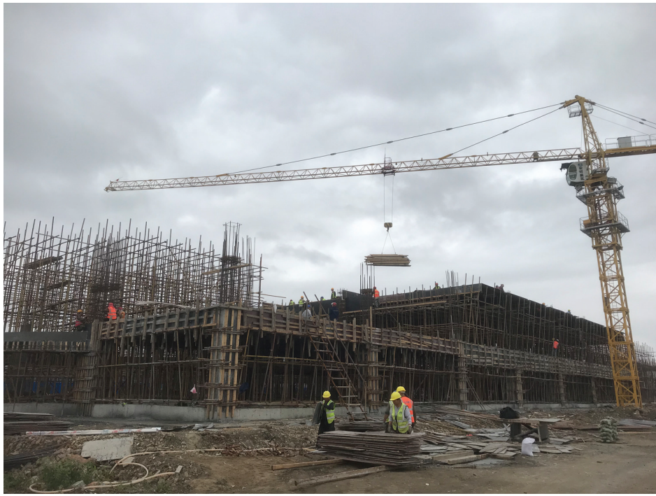
↑图为红旗国际汽车文化旅游小镇项目建设现场 本报记者 张雪楠 摄
