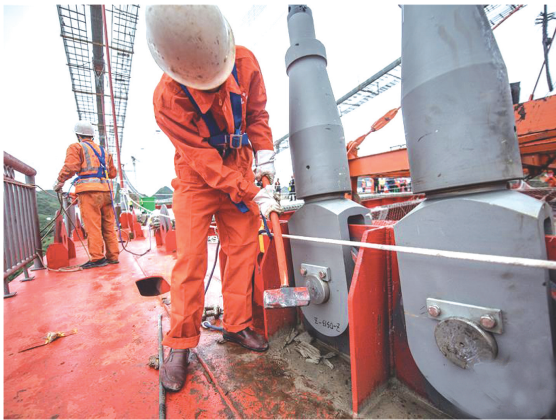
近日,随着107吨的钢主梁稳稳落在预定位置,峰林特大桥顺利实现合龙。峰林特大桥是贵州兴义环城高速公路重点控制性工程,横跨马岭河峡谷,计划于2020年底建成通车。
