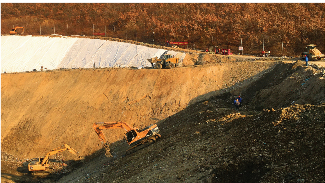
珲春市城市垃圾处理场治理项目进展顺利。该项目包括垃圾堆体开挖工程、堆体整形与临时覆盖工程、垃圾渗滤液应急处理工程、分区填工程。项目完工后,将有效改善珲春市人居环境。图为项目施工现场。
