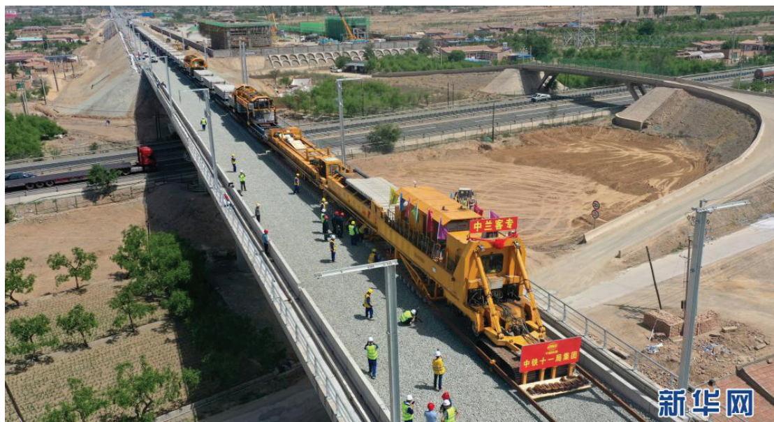
5月30日,中铁十一局建设者操作CPG500型铺轨机在中兰客专甘肃段新墩特大桥上进行铺轨作业(无人照照片)。
