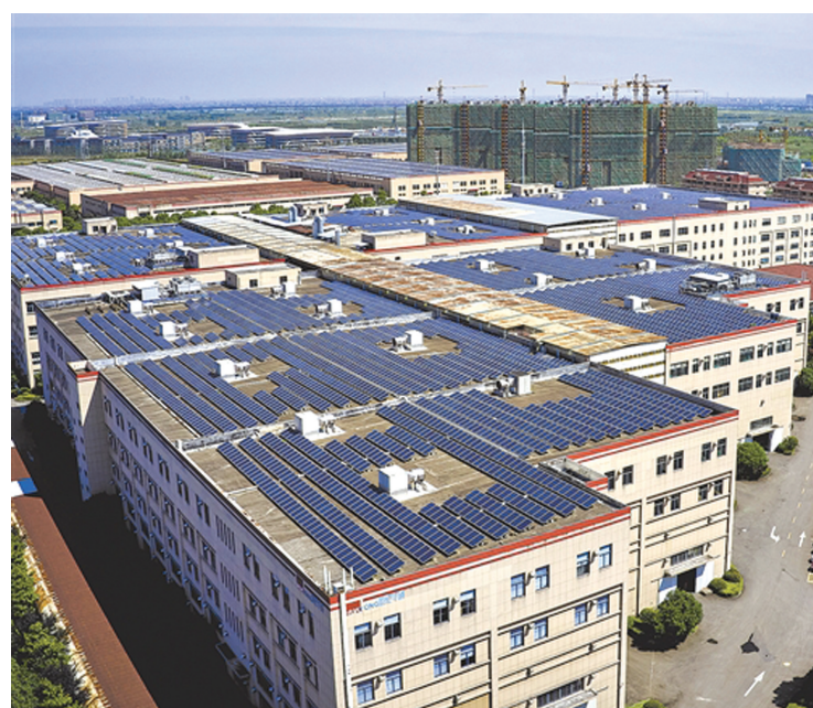
↑图为浙江省绍兴市上虞区源网荷储微电网示范站屋顶光伏电站。上虞区源网荷储微电网示范站是国内首个用户侧商业化运营的项目，建设落地以来，实现了高密度可再生能源的高效利用和交直流负荷的高可靠性供电。
