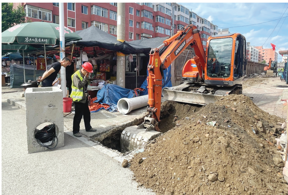
珲春市扎实推进老旧小区改造,通过系统改造使老旧小区完成“美丽蜕变”,焕发了新活力,提升了群众的幸福感与获得感。图为老旧小区改造现场。 本报记者 崔美玲 摄
