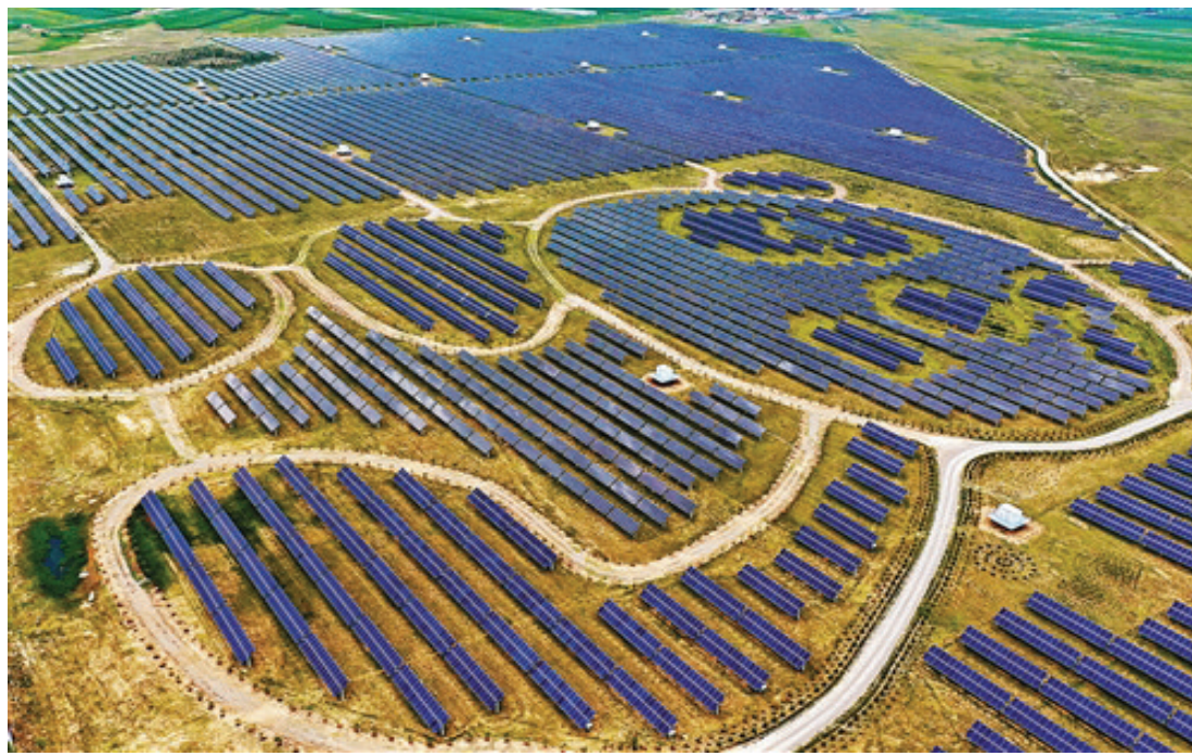
这是8月3日拍摄的“熊猫电站”(无人机照片)。位于山西省大同市云州区杜庄乡土井村的大同熊猫电站是以熊猫为造型的光伏电站。该电站建设在1851亩盐碱地上,年发电量达8000万千瓦时。
