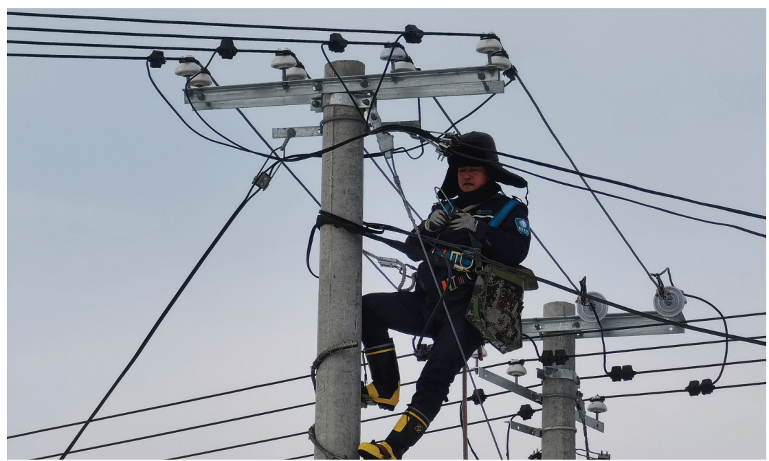
图为国网琿春市供电公司英安供电服务区运维员孙德林在进行户外作业。 本报记者 张岳琦 摄
