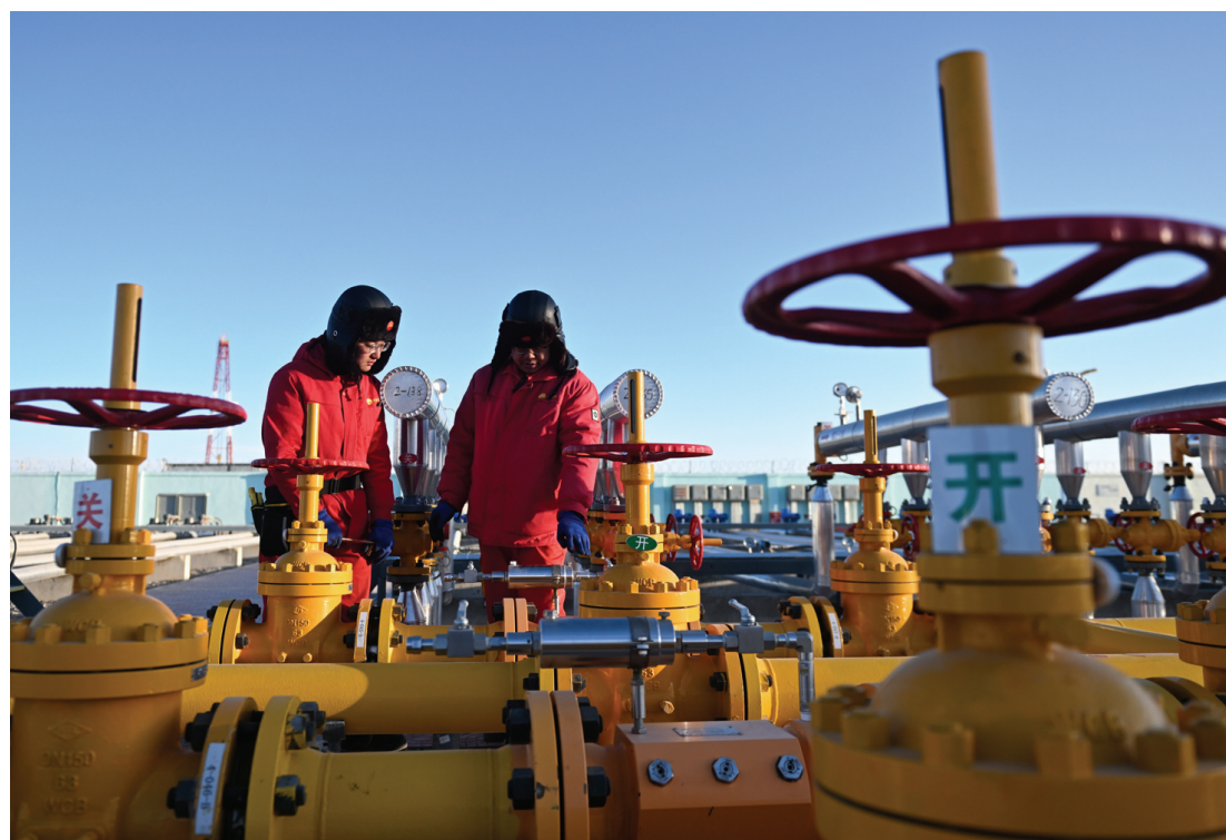
1月26日，在中国石油天然气集团公司青海油田公司采气一厂，工人在检查输气管道。涩北气田地处柴达木盆地东部的戈壁，是“涩—宁—兰”管道的气源地和“西气东输”管道的主要接替气源之一，平均海拔2780米。该气田承担着青海、甘肃、西藏、宁夏四个省区多个城市的供气任务。随着极寒天气到来，为保证民生用气，中国石油天然气集团公司青海油田公司采气一厂的工人们加强安全管理，24小时不停歇保障供气安全。
