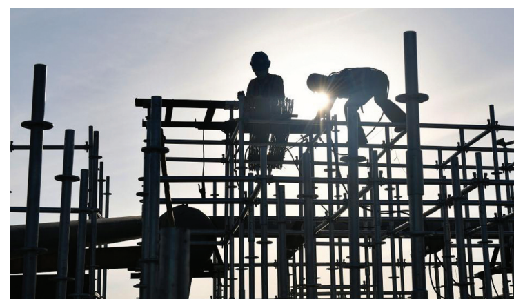
5月3日,工人在三峡大坝附近的湖北省宜昌市秭归县茅坪游轮母港换乘中心建设工地上施工。“五一”假期,不少劳动者仍坚守在岗位上。 新华社发(王辉富 摄)
