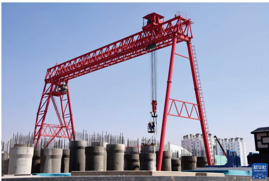
6月14日,工人在郑济高速铁路濮阳至省界标段装配式桥梁墩柱预制场工作。近日,由中铁上海工程局承建的郑(州)济(南)高速铁路濮阳至省界标段,正加紧进行大范围装配式一体化桥梁架梁施工。据介绍,装配式桥梁架梁施工工艺是将桥梁墩柱、墩帽、箱梁分别在预制场进行预制,再运到现场组块施工,大幅提高了高铁桥梁的施工效率。
