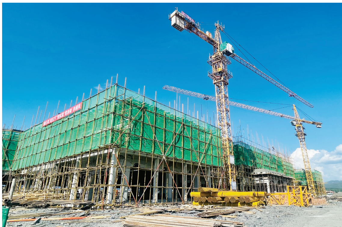
珲春市延边黄牛集中繁育养殖示范区项目进展顺利。该项目总投资9.77亿元,主要建设综合科研区、生产繁育区、饲料加工与储存设施等四个功能区。项目建成后,可存栏繁育牛500头、子牛1500头、成牛5000头。项目建成后,将有效促进全市黄牛养殖产业快速发展。图为项目建设现场。 本报记者 崔美玲 摄
