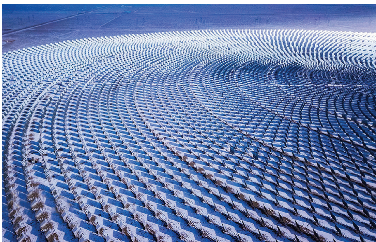
12月3日,雪后初霁,甘肃省敦煌市光电产业园区内,万余面定日镜以同心圆状围绕吸热塔,蔚为壮观。敦煌光电产业园区作为甘肃省集中连片面积最大、装机容量最多的园区,立足国家新能源战略布局的重要支点和西北清洁能源向中东部地区输送的重要通道,利用大面积的戈壁、荒漠大力发展新能源产业,不断推动经济社会绿色化、低碳化高质量发展。王斌银 摄(人民图片网)
