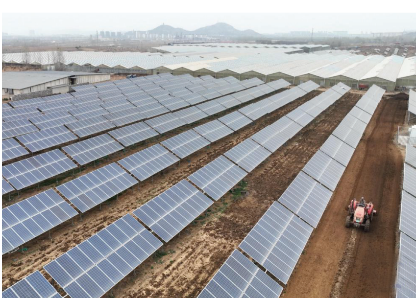
4月3日,工人在秦皇岛市抚宁区区域镇一处“农光互补”项目的光伏发电板上驾驶农机耕种土地(无人机照片)。近年来,河北省秦皇岛市抚宁区因地制宜发展“农光互补”光伏电站建设,采取“企业+农户”的合作模式,将光伏发电和高效农业有机结合,促进企业增效、农民增收,助力乡村振兴。
