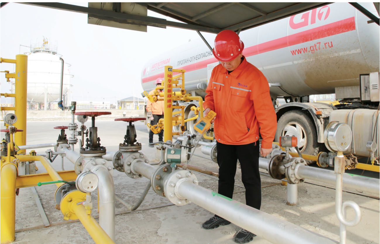
图为吉林省鸿兴能源有限公司工作人员在检查燃气设施。
