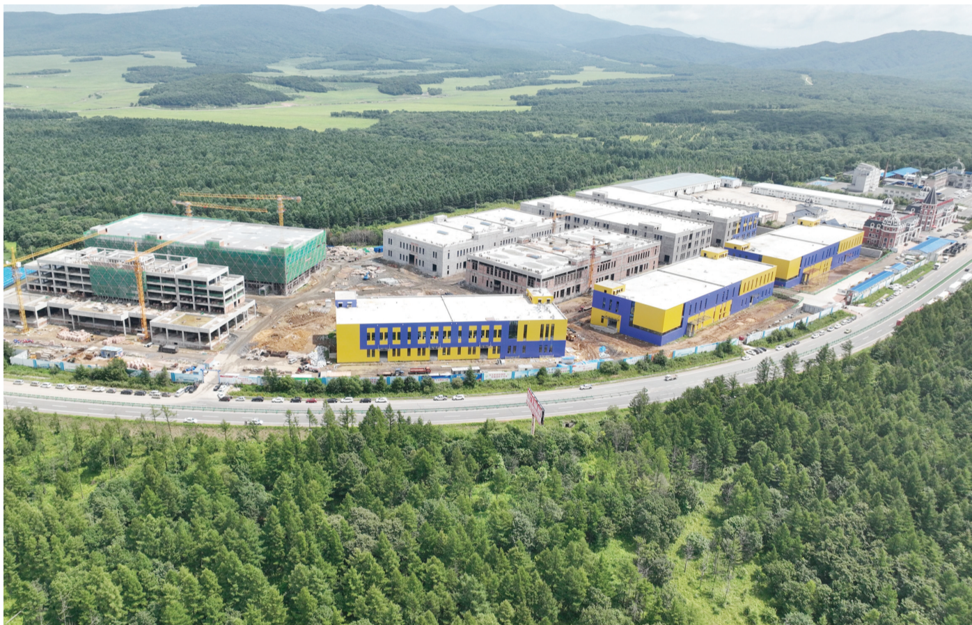
珲春中俄互市贸易现代物流集散中心项目进展顺利。项目总投资7.32亿元,占地面积12.8万平方米,建筑面积13.12万平方米,主要建设综合办公楼、加工厂房、冷库、物流厂房及附属配套设施。项目建成后,可全面整合提升珲春现有物流存量设施,加快补齐物流设施短板,构建符合地区发展的物流通道网络和现代物流服务体系,打造经济发展新引擎。图为项目鸟瞰。
