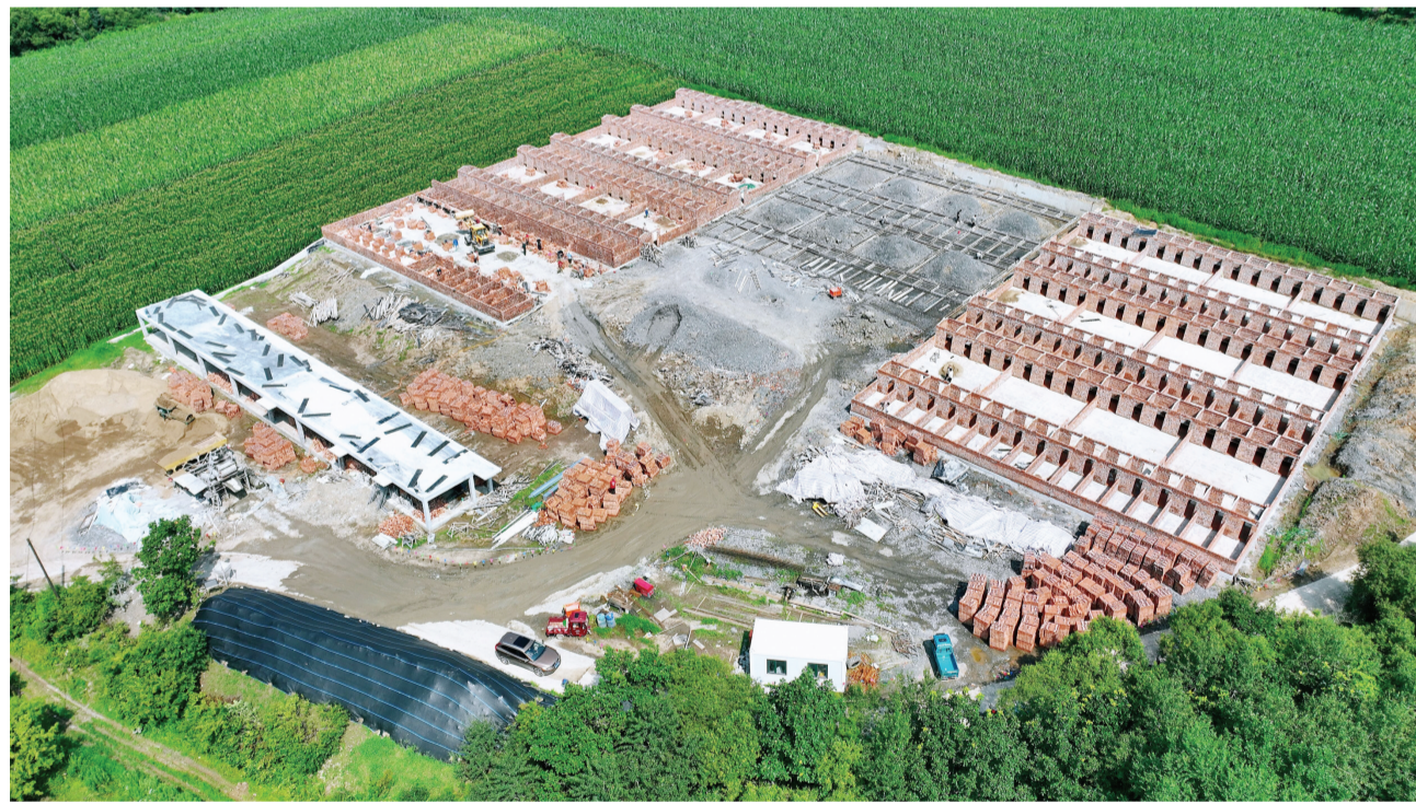
位于琿春市哈达门乡涌泉村的北药集团林麝养殖基地项目进展顺利。项目占地1万平方米,新建林麝标准化圈舍320间,预计9月初完工,10月中旬投入运营,计划一期养殖林麝150只。养殖基地将通过“公司+村集体+农户”的生产经营模式,吸引周边村民参与养殖、务工,带动更多村民增收致富。图为项目施工现场。本报记者 郎鹏 摄
