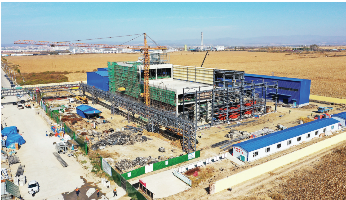
计划总投资3.56亿元的吉林紫金铜业有限公司冶炼渣资源综合利用项目进展顺利。项目分两期建设,建成后生产硫酸亚铁、聚合硫酸铁等产品,产品将应用于水产养殖和污水处理等领域,市场前景十分广阔。图为项目建设现场。
