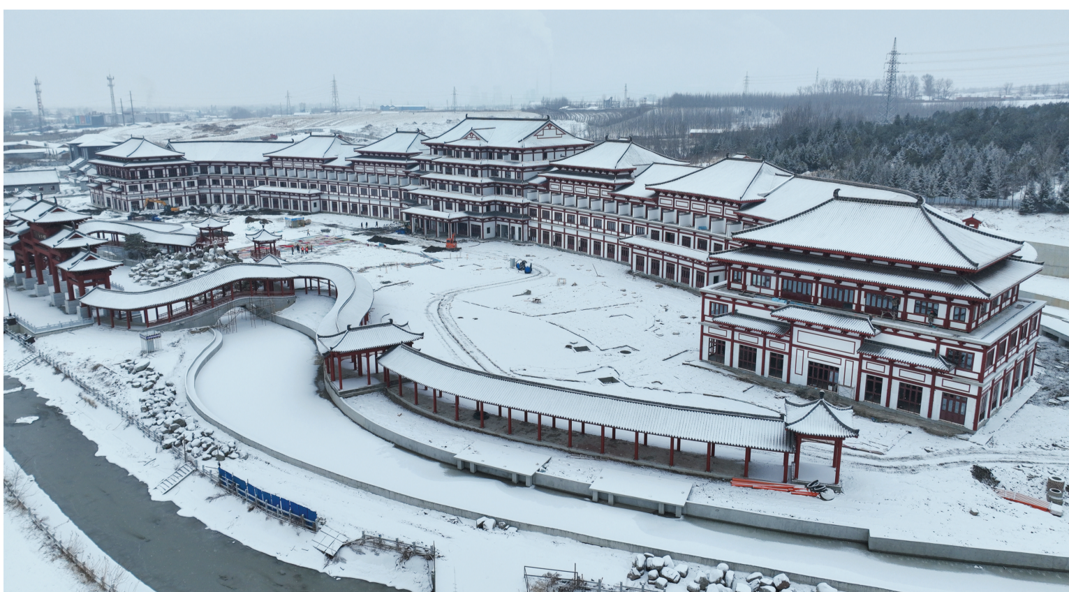
近日,珲春市迎来降雪天气,天地之间银装素裹,犹如一幅水墨画卷,一派壮美的北国风光。图为白雪“装扮”下的珲春丝绸之路渤海古镇旅游基础设施建设项目现场。
