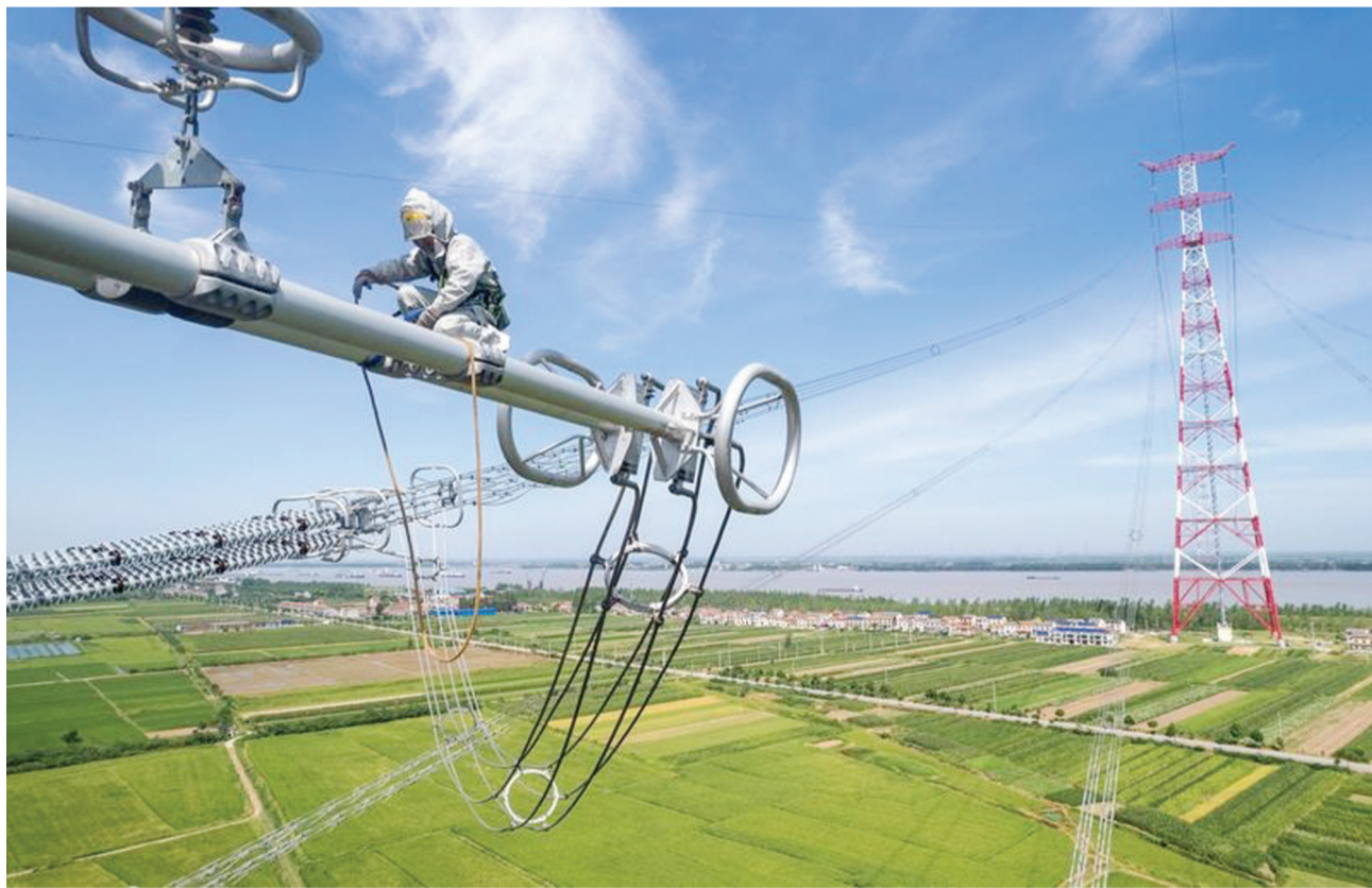
7月23日,在南荆长特高压工程荆满线,电力工人在对线路进行检修(无人机照片)。为确保迎峰度夏期间电力可靠供应,当日,在湖南省临湘市江南镇,国网湖南超高压输电公司对1000千伏南荆—荆门—长沙特高压交流工程荆满线进行带电检修。据了解,南荆长特高压工程是华中地区特高压线路主网架的重要组成部分,该线路横跨长江,通过开展此次检修,有助于提升湖南、湖北地区电力交换能力和电网安全稳定水平。新华社记者 陈思汗 摄
